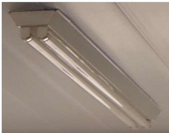
LUMINÁRIA TIPO CALHA
